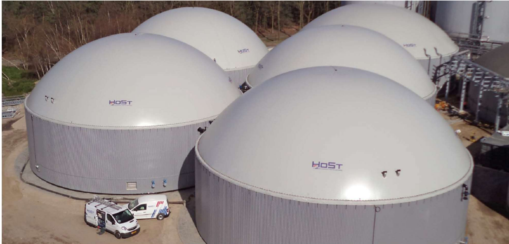
Digestori a «panettone» con gasometro sulla cupola
